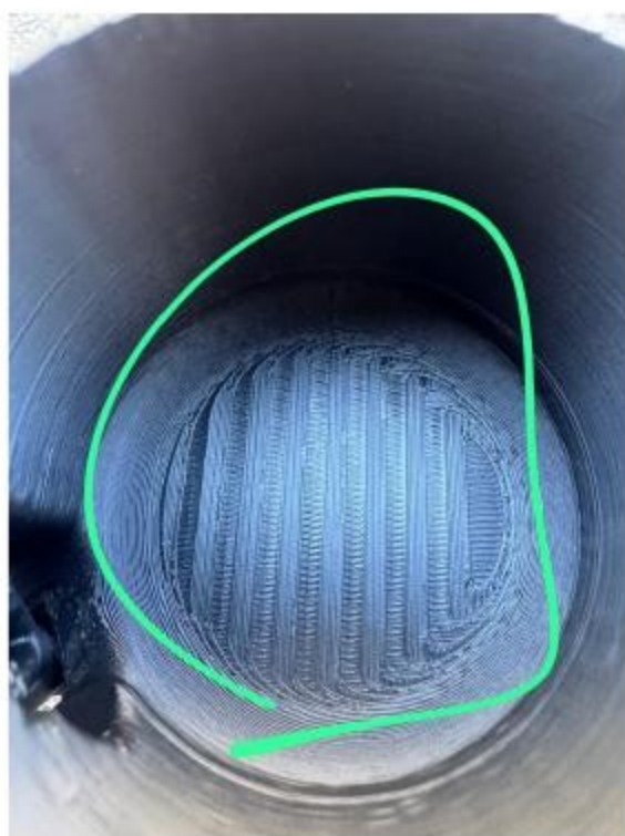
Fig. 38 Vedere în interiorul găurii după curățare – traseul înghețului este vizibil prin geometria ridurilor și geometria din zona marginală
